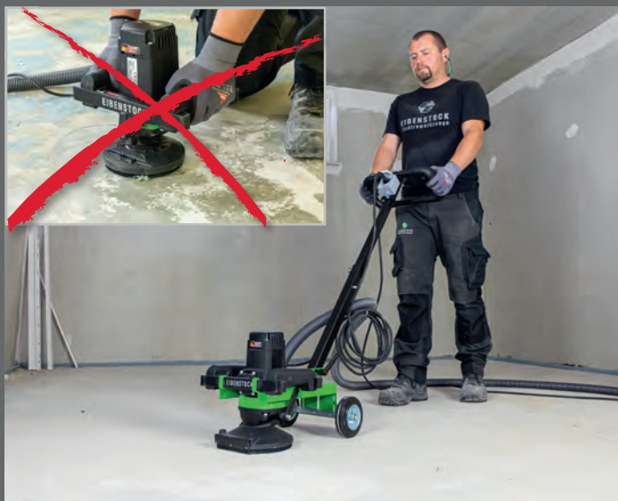
Lavoro delicato per la schiena con il telaio di guida sul pavimento
